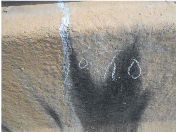
S2 방호벽 균열(0.3mm미만)
