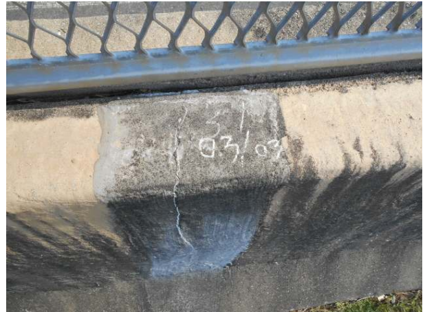
S1 중앙분리대 균열(0.3mm이상)
