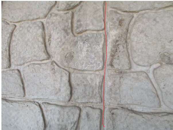
A1 교대 균열(0.3mm미만)
