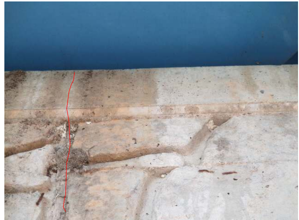
A1 교대 균열(0.3mm이상)
